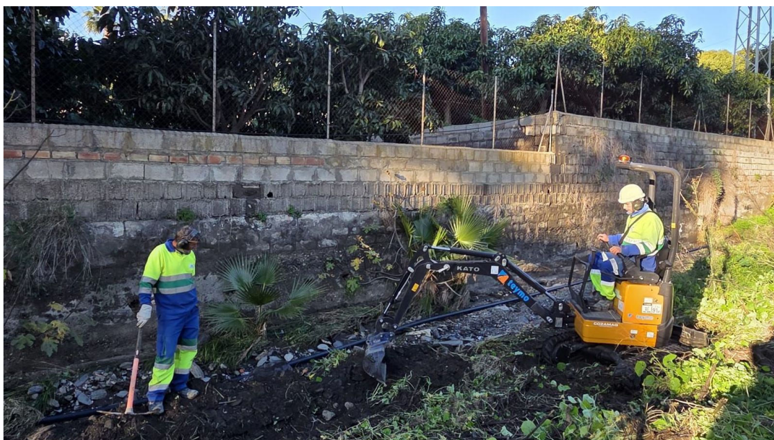
Dos operarios trabajando en una de las zonas afectadas
